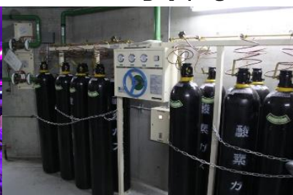
医療用酸素供給設備
